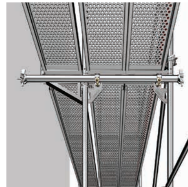
Moise Universel, fixée par des colliers d'ancrage.
